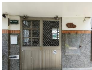
圖書館舊式紗門及鐵門
